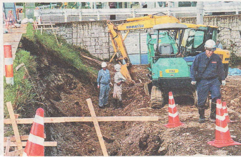
掘削工事中に土砂が崩れた松本市渚の現場
